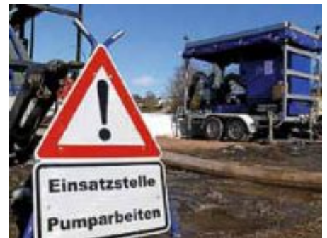
Großpumpe Foto: THW
